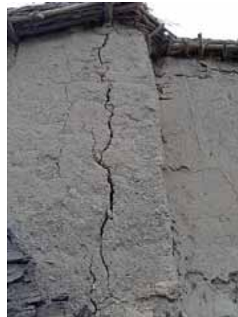
نگاره ۴: نمایی از ترک‌های عمودی در دیواره منازل که ناشی از عامل رانش زمین است
